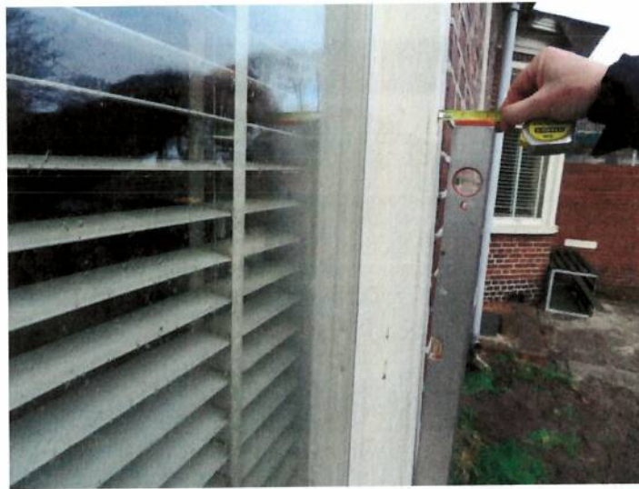
Foto 3: Scheefstand onderzijde zijgevel.
