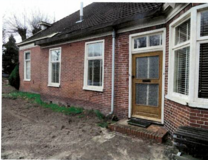
Foto 1: Instabiele rechter zijgevel.
