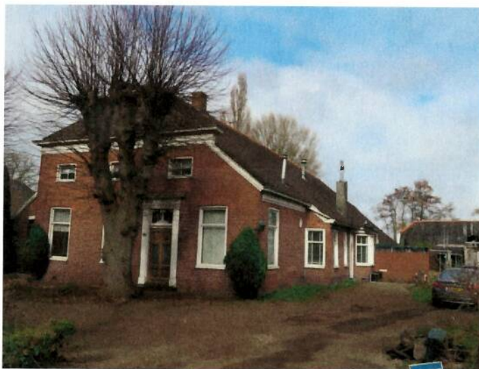
Foto 2: Instabiele rechter zijgevel.
